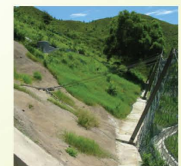
東灣柔性防護欄 Flexible barrier in Tung Wan
