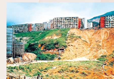
圖10. 1972年秀茂坪山泥傾瀉導致71人喪生。 Figure 10. 1972 Sau Mau Ping landslide (71 fatalities).
